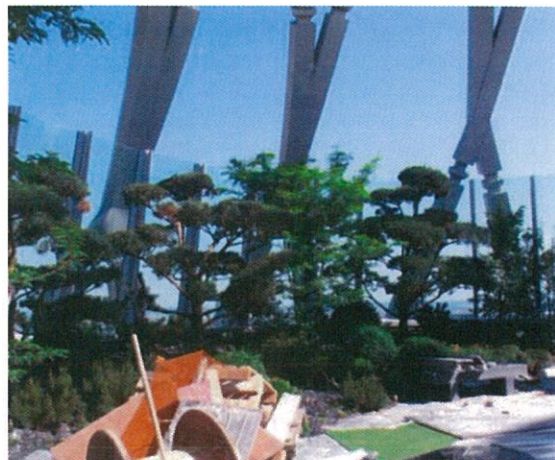
La Défense, le 12 juin. Cerise sur le gâteau : le dôme arrondi abrite un jardin de pins, encore en plein chantier. (LP/F.H.)
